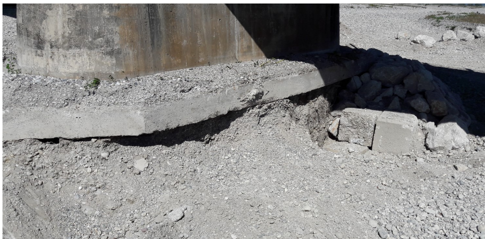
Figura 25 – escavazione attorno alla pila 28 (numerazione da Spilimbergo a Dignano) – sopralluogo settembre 2018
